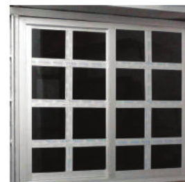
Protecciones en puertas y ventanas
